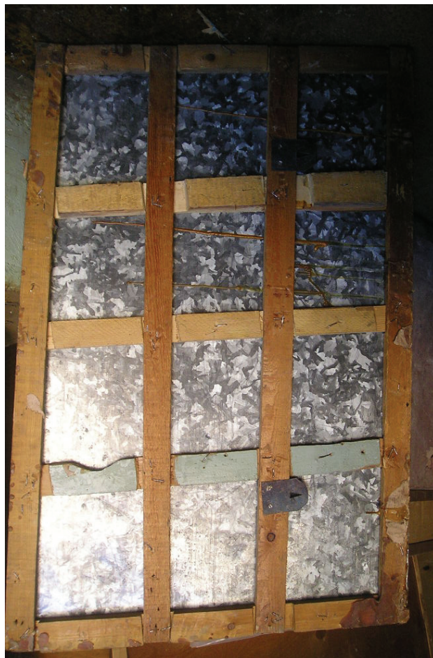
Рис. 1. Тыльная сторона старого монтажного щита из жести
